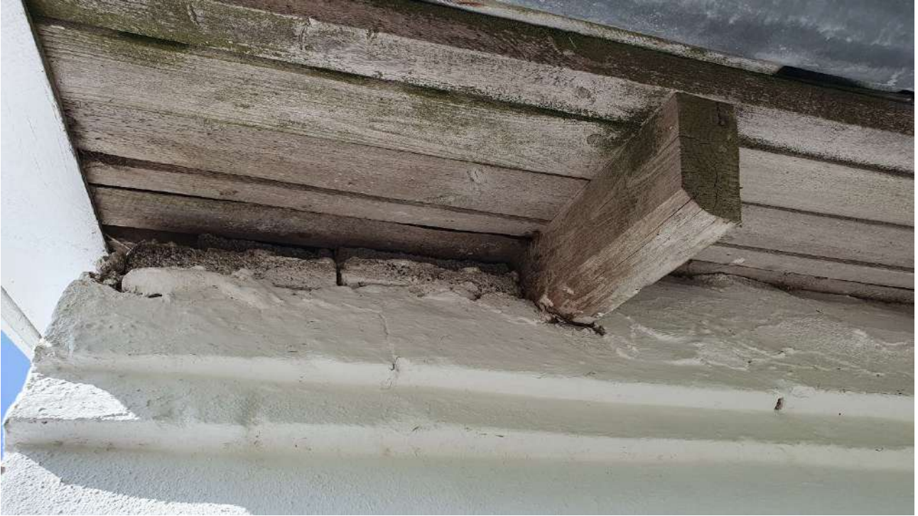
Figur 8: Mellemrum mellem planker og mellem udhæng og mursten.
