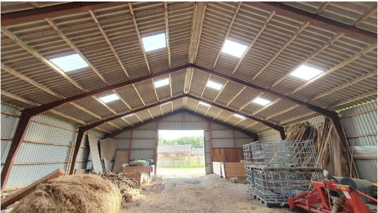
Figur 32: Halmlade indefra. Konstruktionen er ikke velegnet for at flagermus kan leve der.
