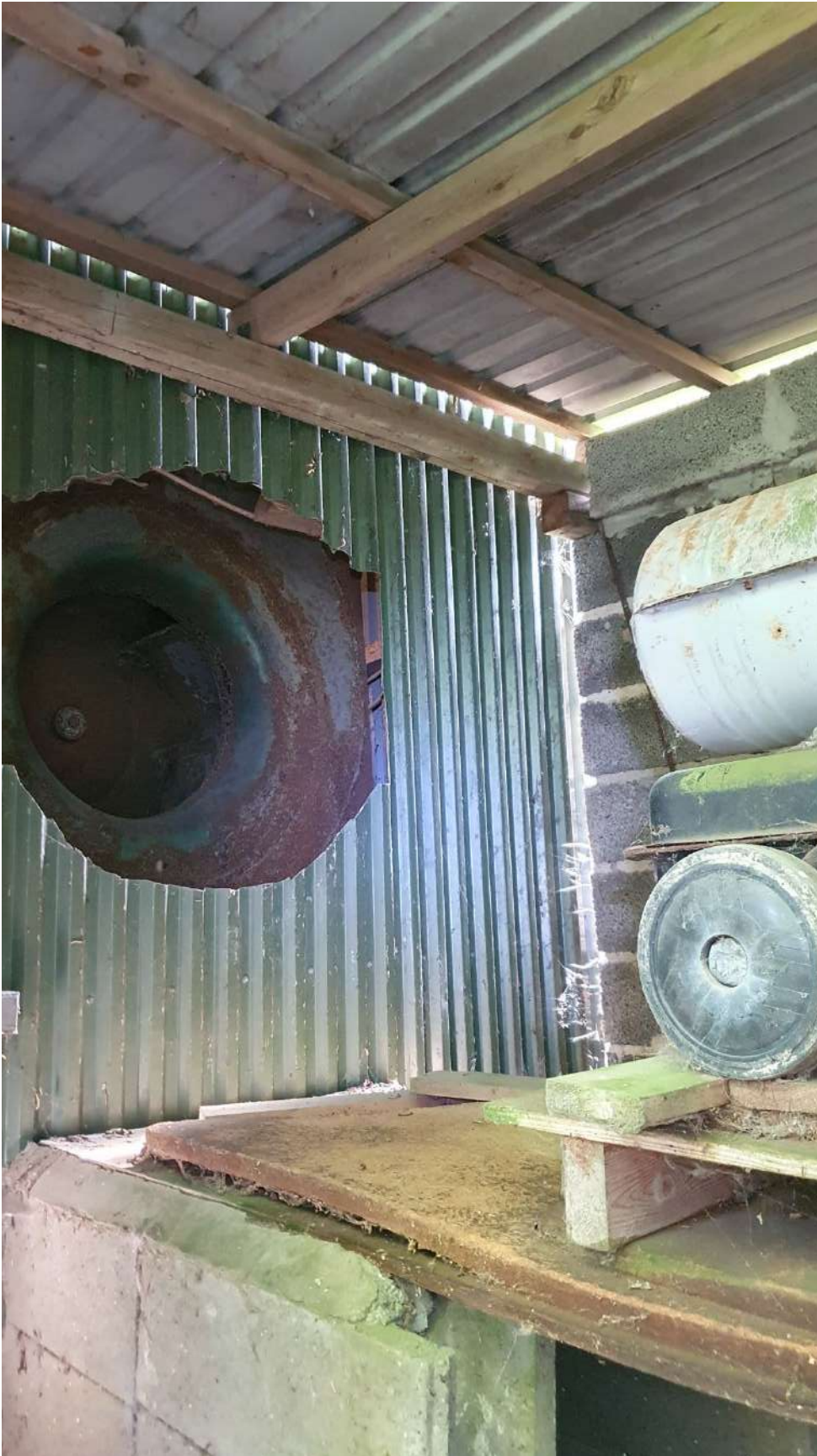
Figur 34: Skur indefra. Konstruktionen er ikke velegnet for at flagermus kan leve der.
