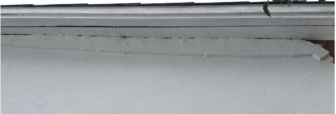
Figur 4: Udhæng med mellemrum mellem planker.
