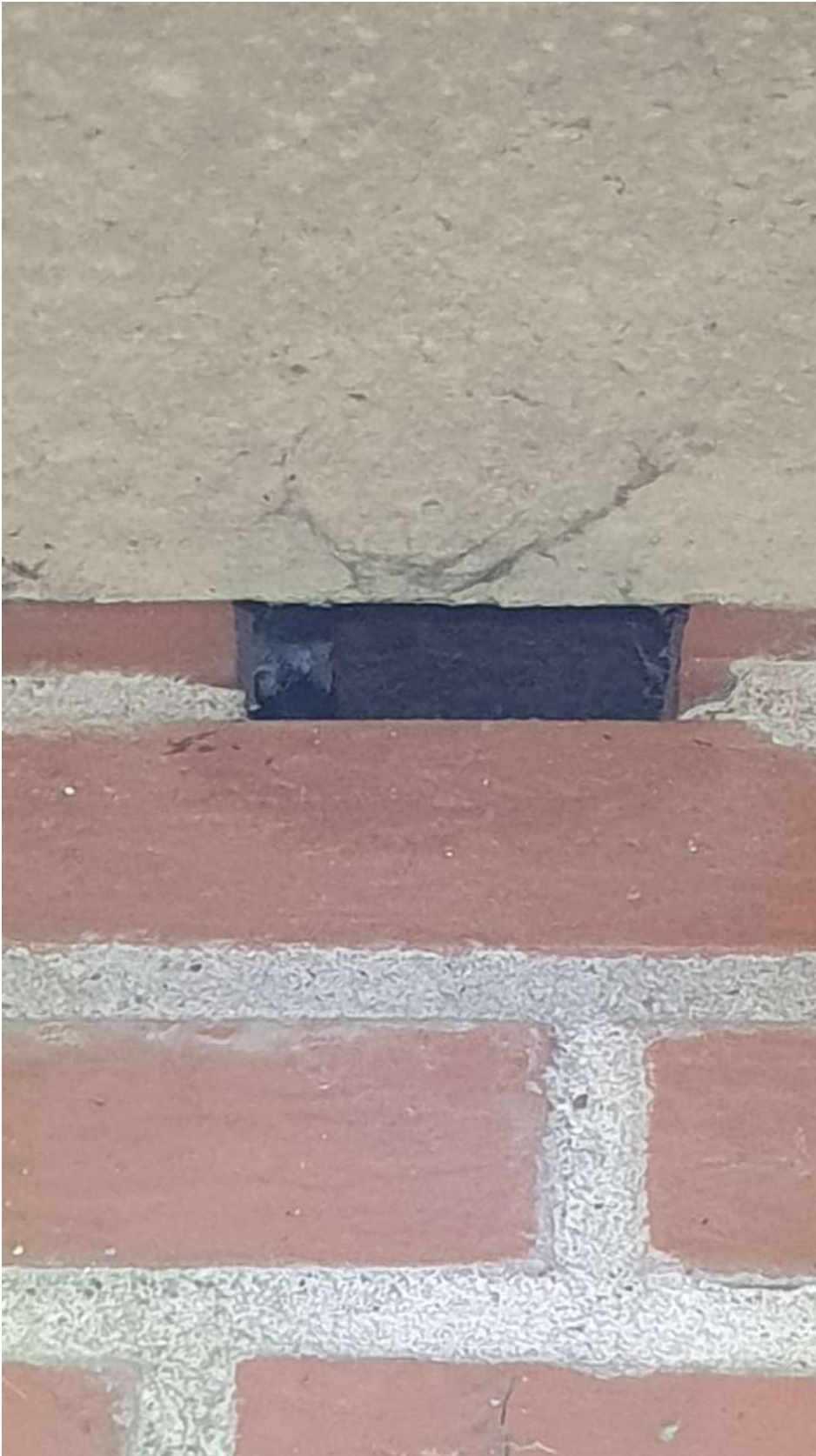
Figur 17: Hul i murstenene på staldsiden.
