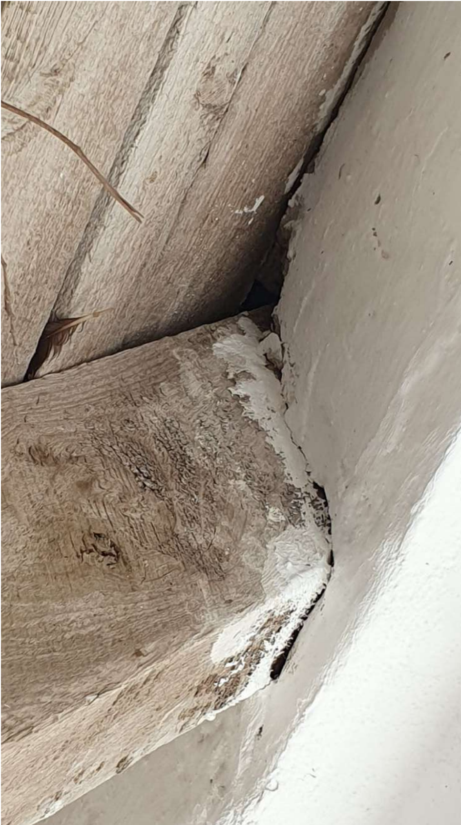
Figur 11: Mellemrum mellem spær, planker og mursten.
