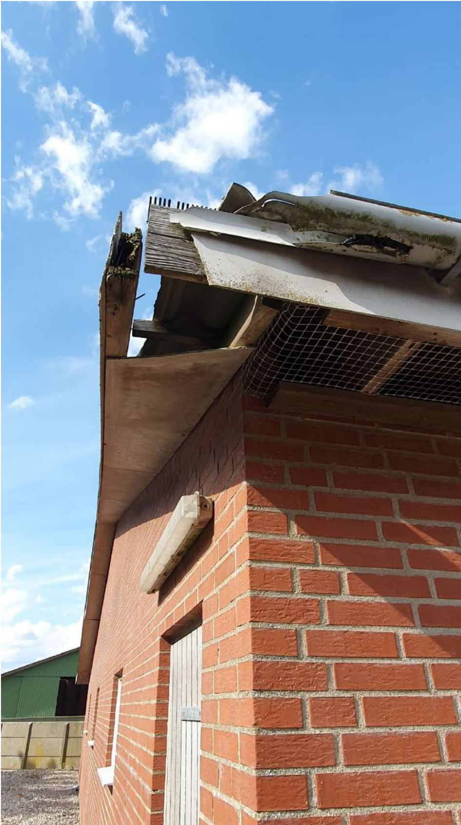
Figur 21: Skadet hjørne af gavl. Stort hul.
