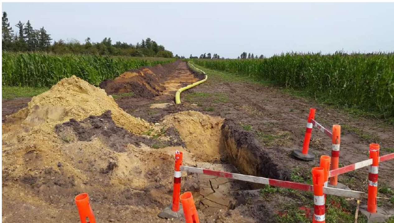
Figur 1: eksempel på anlæggelse af gasledning i rørgrav. Boregrube til underboring ses nederst i billedet.
