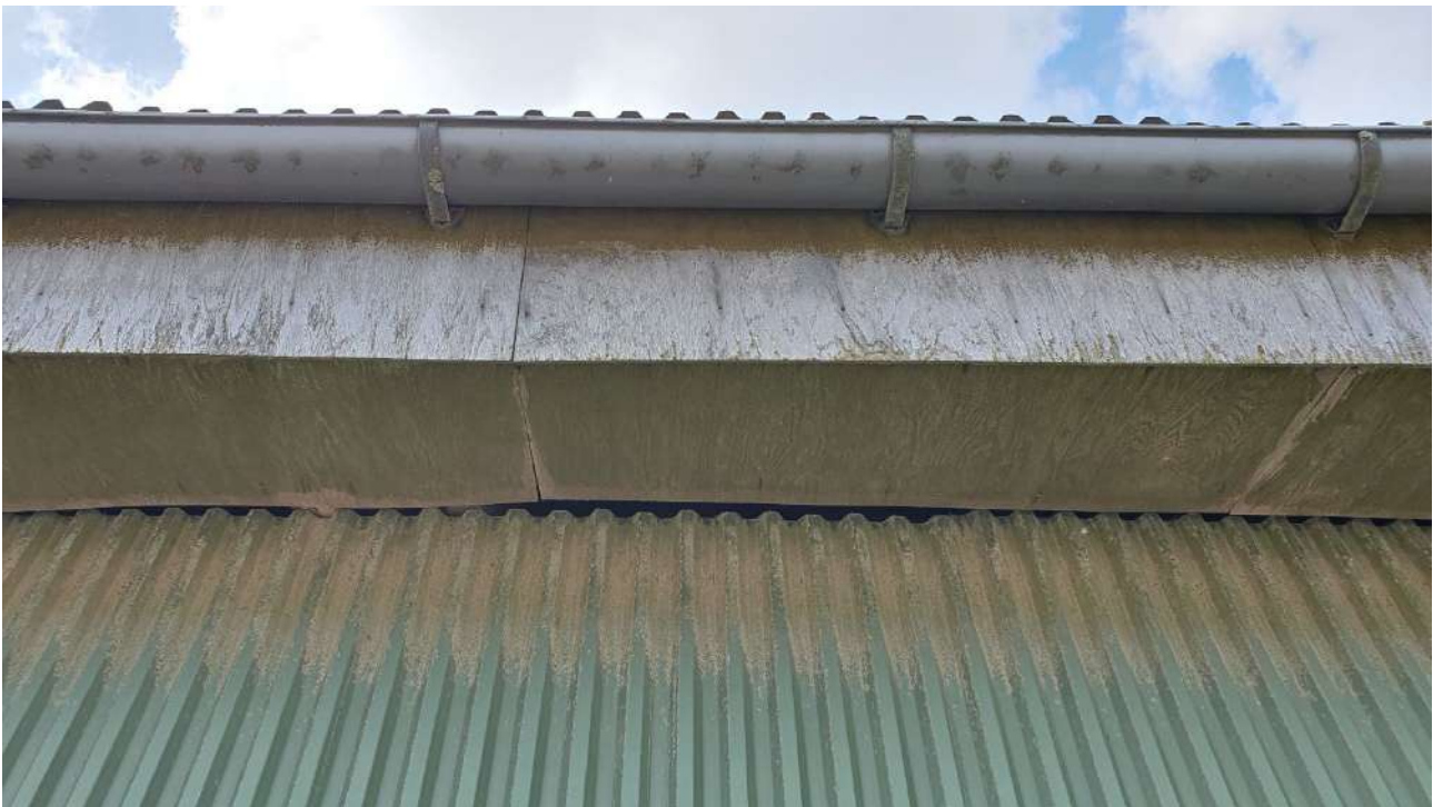
Figur 28: Mellemrum mellem stålæg og udhæng.
