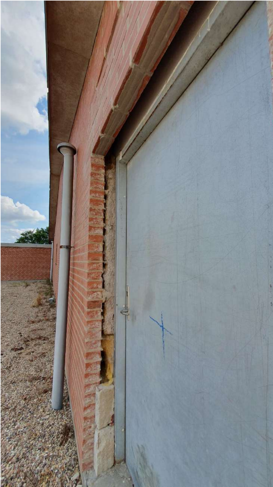
Figur 23: Manglende afspærring af hulmur ved indgang.
