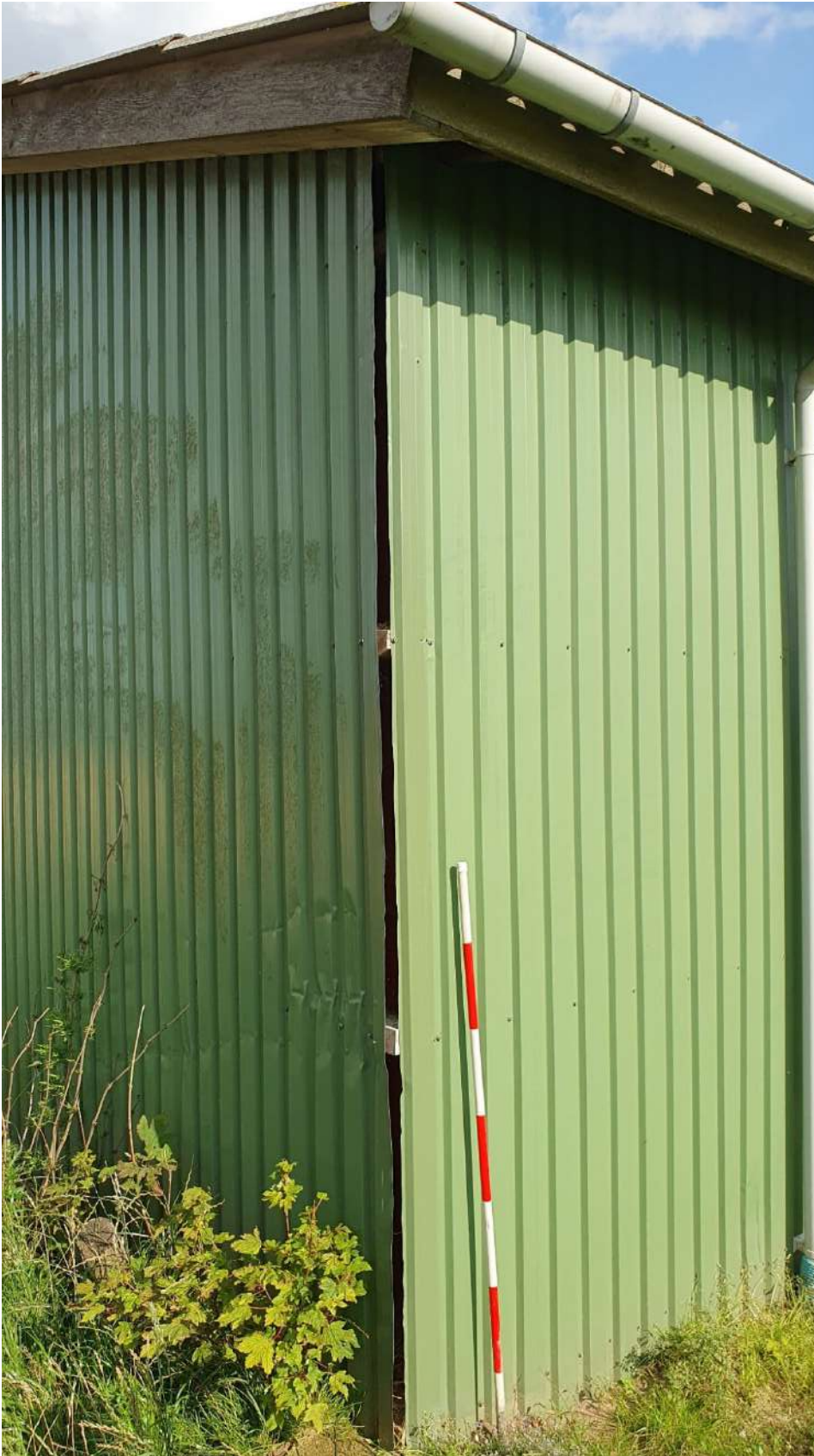
Figur 35: Ladehjørne. Stort mellemrum mellem stål vægge.
